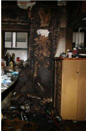
写真 1-1 出火箇所の焼損状況
