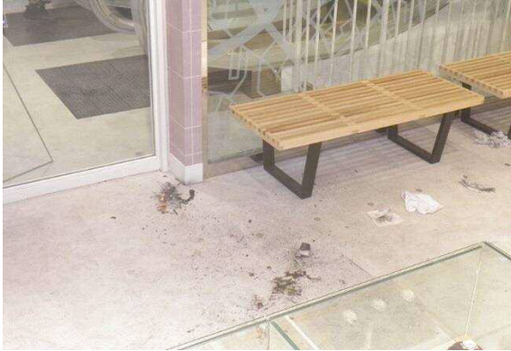
写真3-1 店舗内出火箇所の状況
